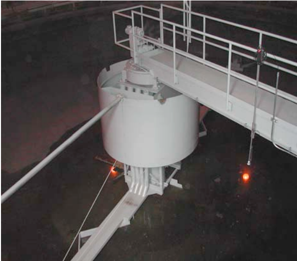
Usine de boues activées
