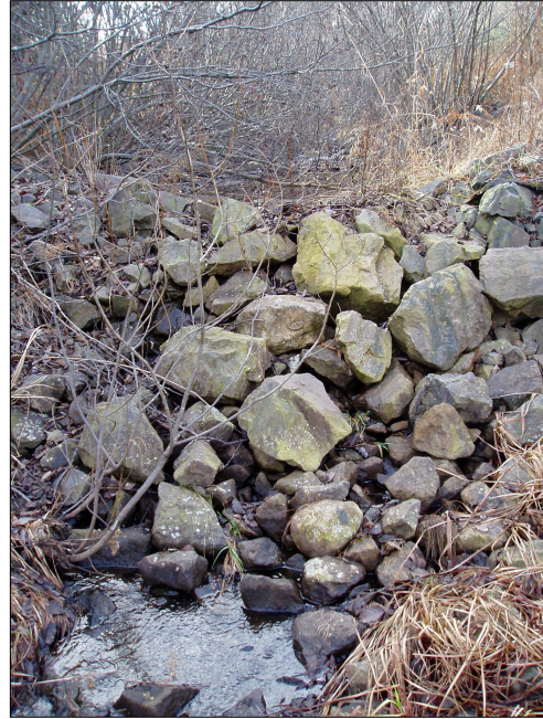
Photo 10 Principale fosse de captage de sédiments fins sur le ruisseau #4
