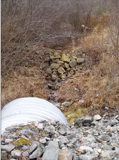
Photo 11 Principale fosse de captage de sédiments fins sur le ruisseau #4
