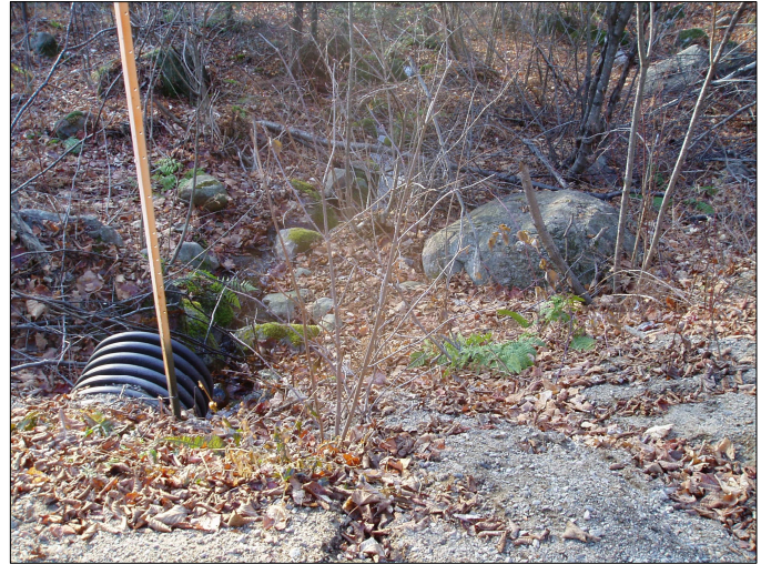
Photo 18 Problème d'érosion à la croisée du ruisseau #5 et la Côte des Intrépides
